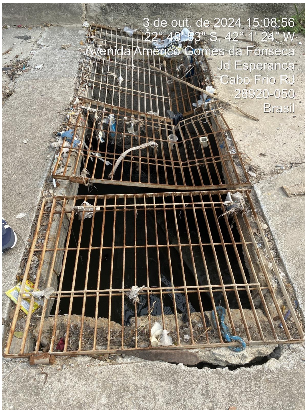
Figura 93 – Condições críticas da estrutura física do canal.
